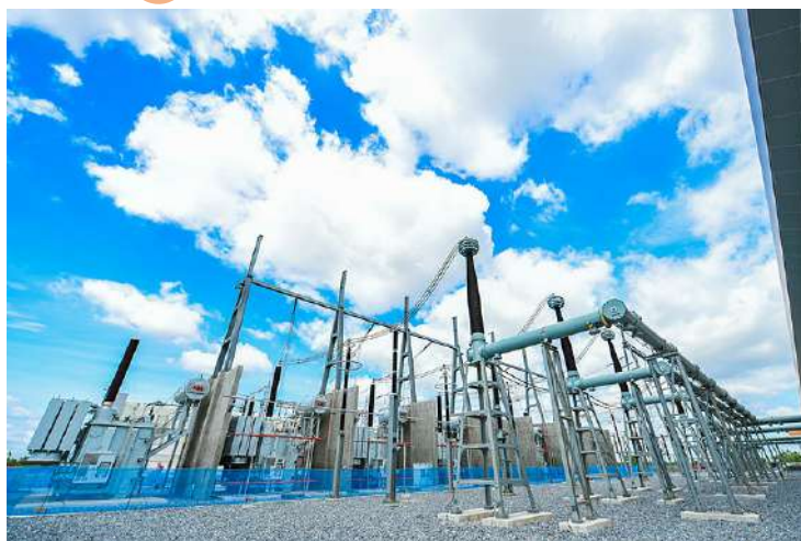
รูปที่ 3.23 สถานีไฟฟ้าแรงสูง (High Voltage Substation)
