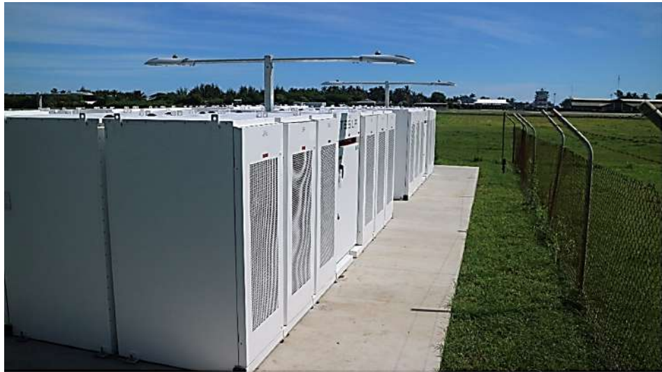
รูปที่ 8.23 โครงการ Rarotonga BESS Project Airport South ที่ ESB's co-located BESS project in Scotland given greenlight
