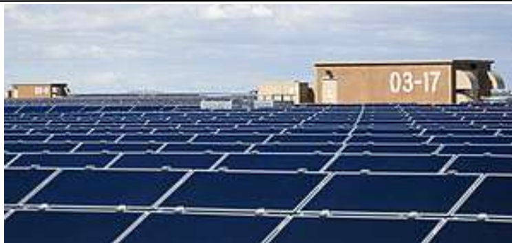
รูปที่ 11.9 Topaz Solar Farm
