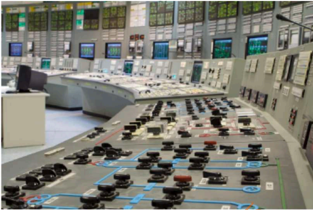
รูปที่ 5.18 ศูนย์ควบคุมโรงไฟฟ้านิวเคลียร์
